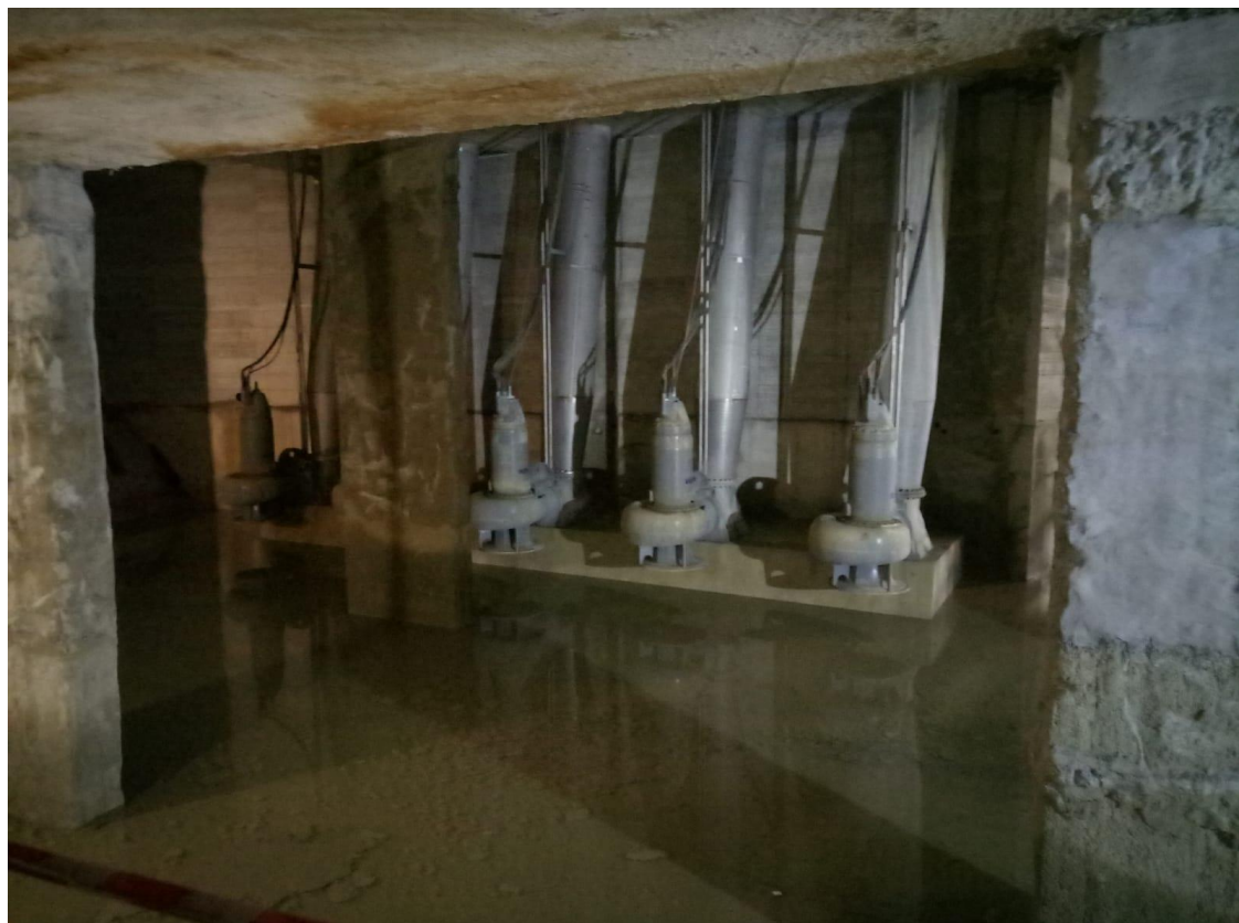
L'impianto di pompe idrovore
