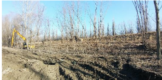
Gestione della vegetazione in alveo e sfalcio delle arginature – f. Reno loc. Trebbo
